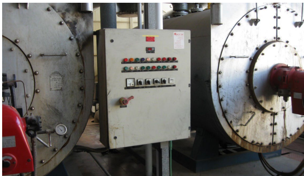
Рисунок 1. Пульт управления энергоблоком
